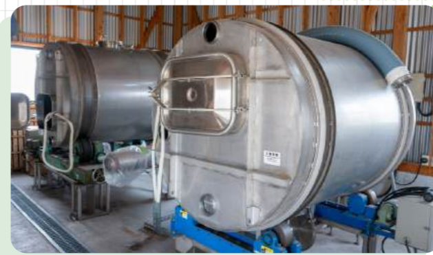
新設された麦芽製造装置
